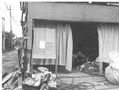
▶「危険」の赤い紙が貼られた建物
